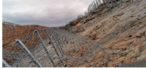
Fv 5398 ved Gullbrå. Støtteforbyggingar i losneområde for snøskred montert i 2020.
