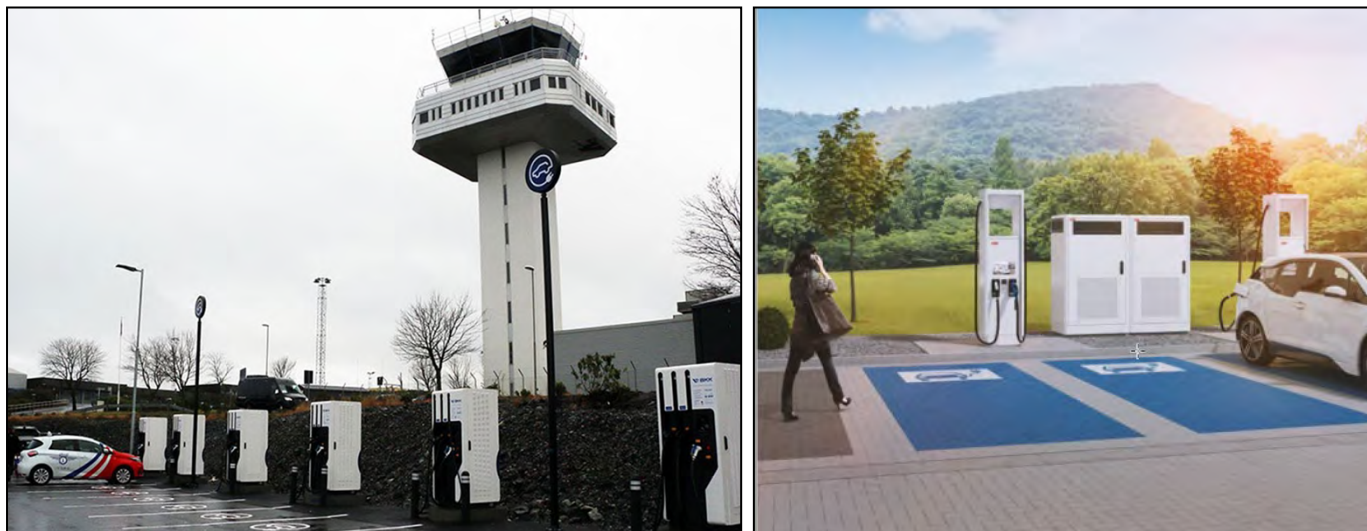
Figur 5 (venstre): Deltaladarar med tre uttak og effektdeling på drosjedepot ved Bergen lufthamn - Foto: Thomas J Potter. Figur 6 (høgre): 350 kW Ladar frå ABB.
