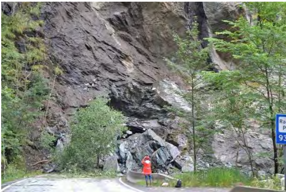
Figur 2.9 Det er registrert 69 skredhendingar på fylkesvegen i Tokagjelet frå år 2000. Hovudproblemet er knytt til steinsprang/steinnedfall frå sideterreng og bergskjering.
