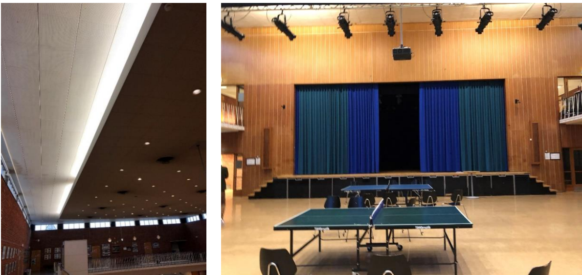
Figur 17: Himling i Aula med innfelt belysning. Original. Scene med fondvegg i Trysilpanel, original. Foto Norconsult 2018.
