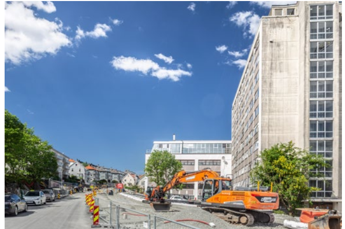
Under arbeid: Sykkelveg med fortau samt trolleybusslinje i Carl Konows gate. Foto: Silje Drevdal
