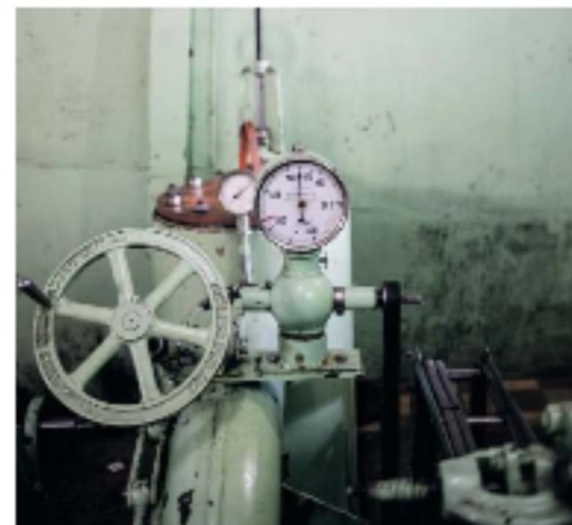
Turtelleren på turbinen skal skiftes ut.
