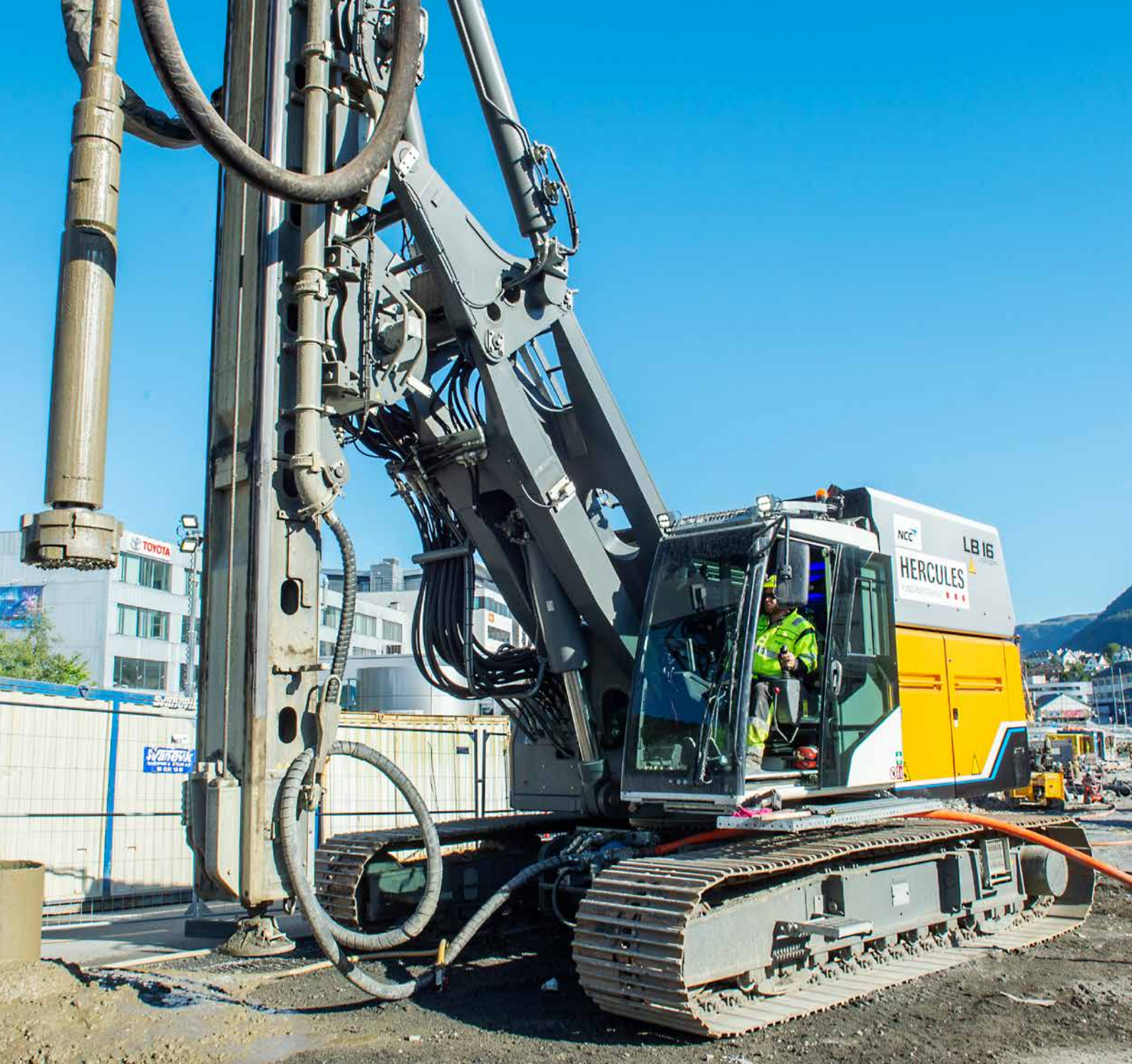
Verdas første og einaste batteridrevne borerigg starta i haust arbeidet med bybanetraseen til Fyllingsdalen. Foto: Marit Hommedal.
