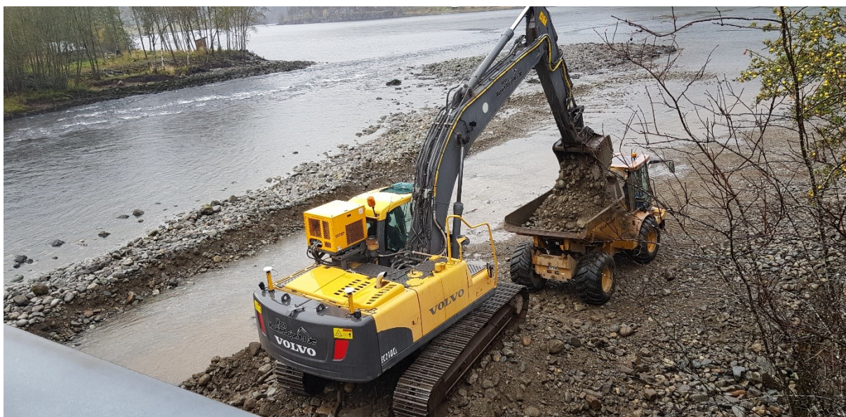
Bilete 2. Fjerning av flaummassar i store vassdrag kan vere viktig for å hindra skade. Her fjerning av massar under Evangerbrua i Vossovassdraget i 2020. Foto: Sveinung Klyve.
