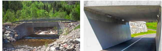
Figur 3 2: Kulvert/bru i fylling. Bilde til venstre er frå fv. 604 i Jostedalen (bruar-kiv, Statens vegvesen). Bilde til høgre er frå fv. 556 Søreide (Multilux as).
