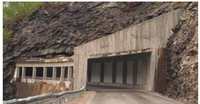
Figur 4 2: Rasoverbygg, fv. 53 ved Ljoteli (Bruarkiv, Statens vegvesen)
