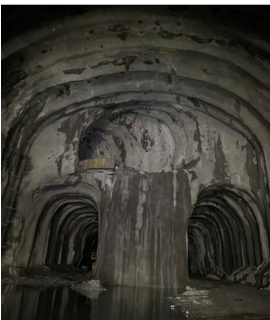
Underjordisk holdeplass: Haukeland sjukehus. Foto: Bybanen utbygging
