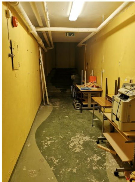
Kjellervegger i betong, noe kalk/salt- utfelling.
