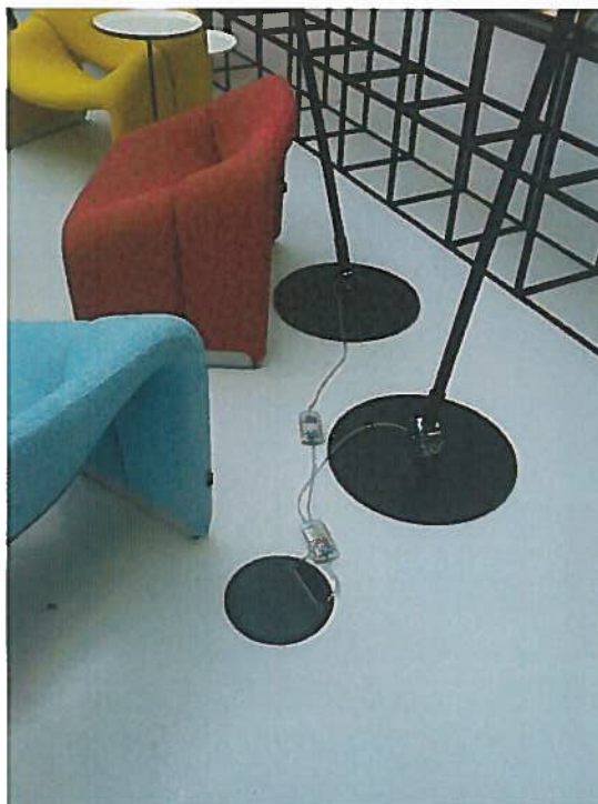
Figur 45 Tilkoblingspunkt i gulv i møbleringssone (foto:L.Aasness)
