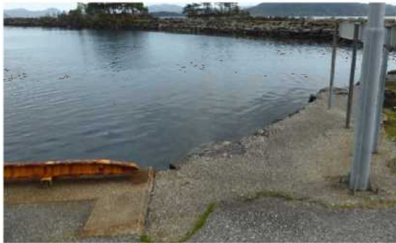
Figur 18 Kaikant der markering og sikring mangler.
