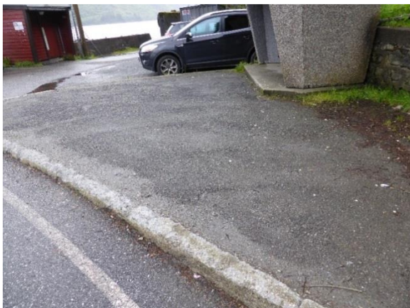
Figur 51 Dårligt og ujevnt dekke på plattform.
