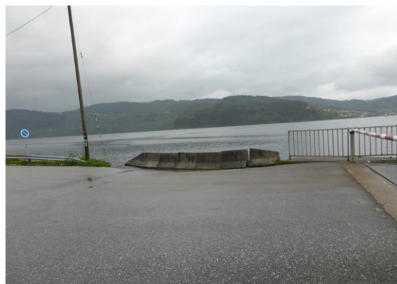
Figur 54 Delvis manglende rekkverk
