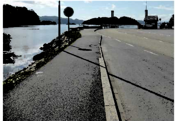
Figur 57 Markering av kaikant og nedsenket kantstein mangler på plattformen
