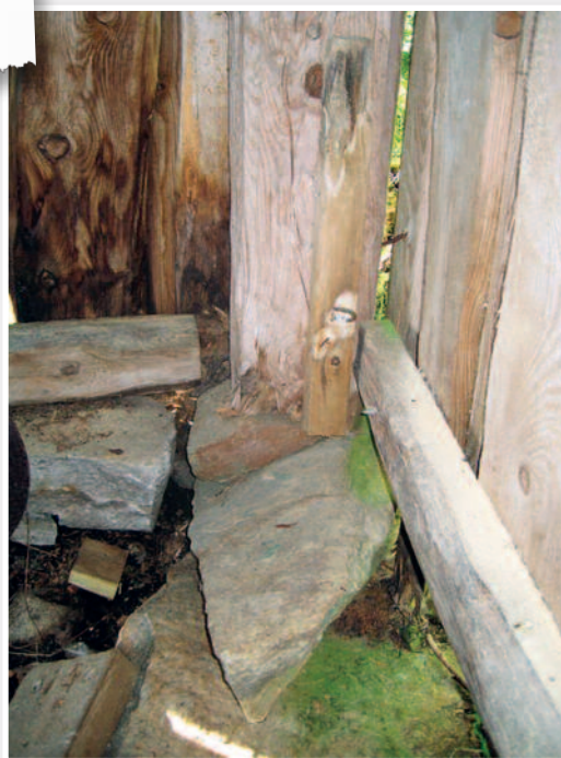
Detalj syd-vestre hjørne 9. juni, ustrast mur og fuktskader
