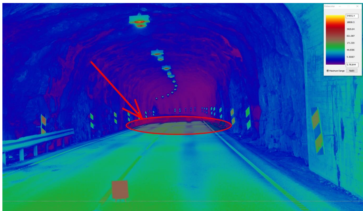
Figur 3. Bildet viser Innkjøringssonen av Raunekleivtunnelen i falske farger. De falske fargene er tildelt piksler med bestemte luminansnivåer. Luminansskalaen er i høyre øverste hjørne av bildet. Den røde ovale formen markerer stedet hvor belysningen reduseres drastisk.
