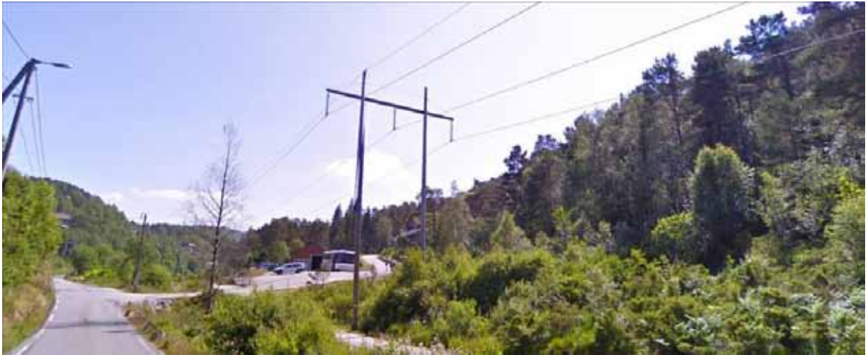
Figur 2.3. Eksempel på 132 kV kraftledning bygget på H – master av trestolper med toppline.
