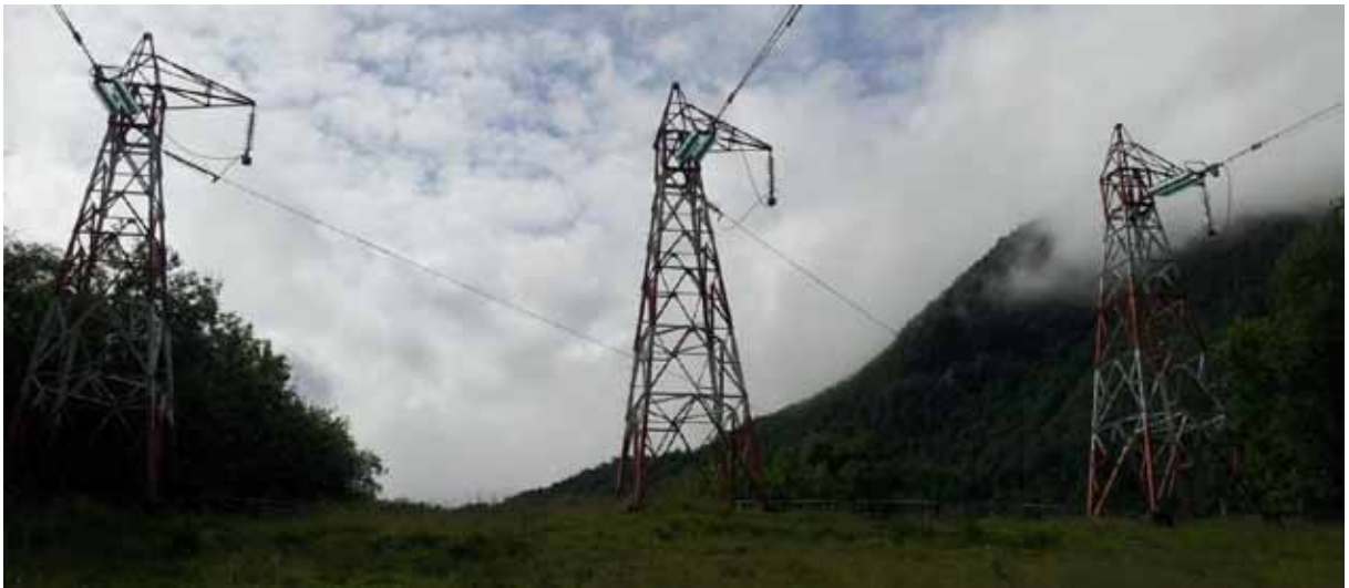
Figur 2.4. Eksempel på 132 kV fordspennmaster.
