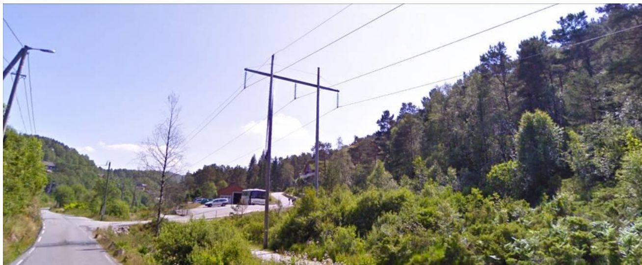
Figur 8. Eksempel på 132 kV kraftledning bygget på H – master av trestolper med toppline.
