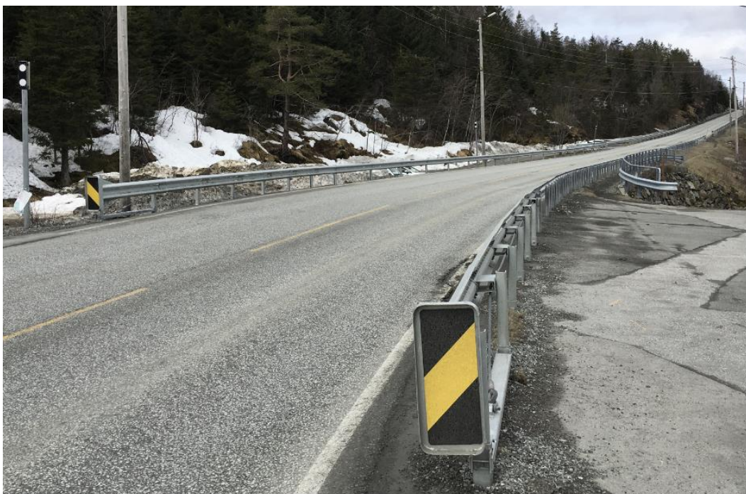
Figur 16: Rekkverkstiltak Fv.7 Hardangerveien mellom Trengereid og Gullbotn (Samnanger grense). I hovedsak var tiltaket å skifte ut eldre rekkverk. Ved neste nyasfaltering vil det også bli gjennomført forsterket midtoppperking (sinusfresing) som tiltak mot møteulykker.
