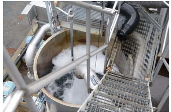
Figure 11: Rensing av avløpsvatn på Boliden i Odda
