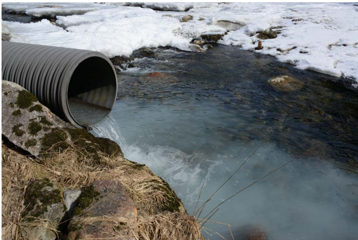
Figur 24. Kloakk på avvege til Daleelva på Dale i Vaksdal kommune 2018. Slik diffus avrenning frå gamle leidningar har ein hatt i mange år på denne staden.
