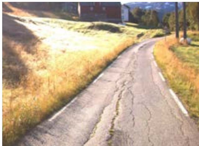
Figur 3: Fv 307 Reimegrend. Djupe hjulspor, sprekkar i asfalten, dårleg veggrunn. (SVV Vegbilete, 26. august 2014).
