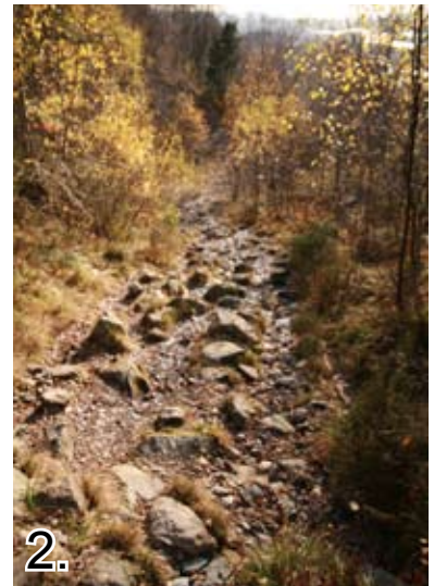
Problemområde. Veien her er bratt og svært steinete. Den mangler drenering så her trengs det tiltak.
