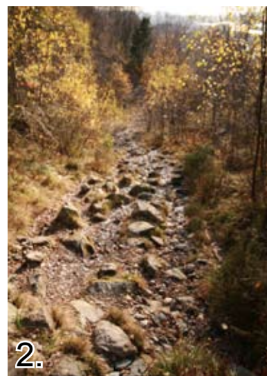
Problemområde. Veien her er bratt og svært steinete. Den mangler drenering så her trengs det tiltak.
