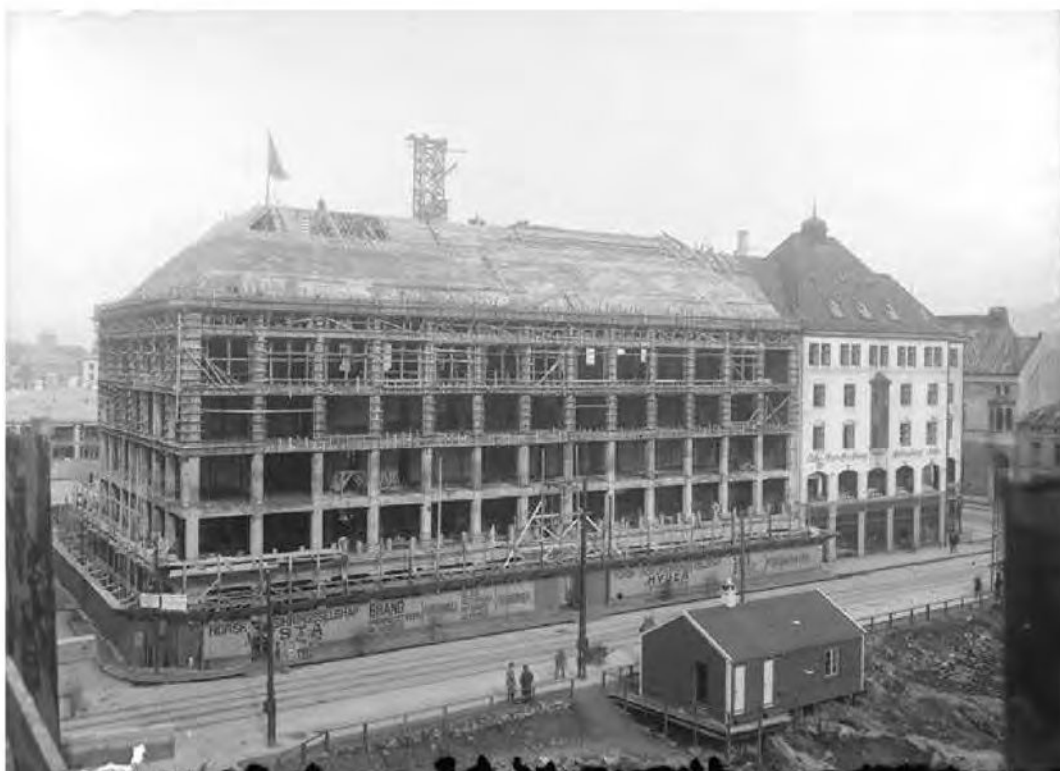
Olav Kyrres gate 1 under bygging, 16.4.1926 (fotograf Atelier KK, UBB-KK-N-257/001, Billedsamlingen, Universitetsbiblioteket i Bergen)
