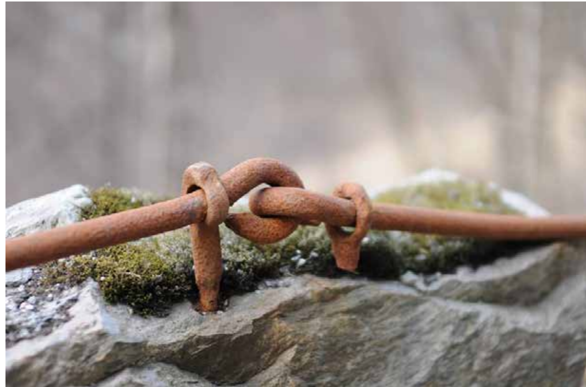
Nokre stader er det framleis råd å oppdage (nesten) intakte detaljar frå gammalt rekkverk, men rustangrep og andre påverknader har ført til at trafikktryggleiken i beste fall er innbilt.
