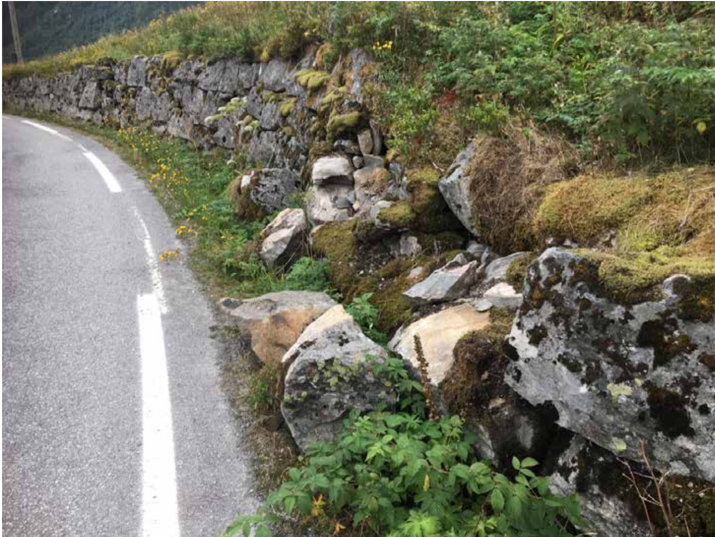
Det er mange år sidan denne muren byrja å rase ut i svingen ved avkøringa til Kallandsklubben. Dei to nederste steinane vart flytta vekk frå den kvite streken av tilfeldig forbispaserande i fjor sommar. Det er ikkje sikkert at det er gåande som først oppdagar dei neste steinane som trillar ut i vegbana.
