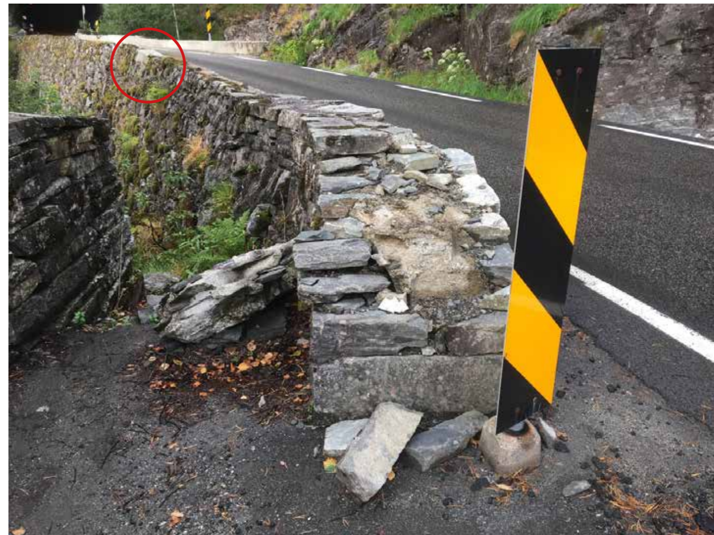
...frå fv 569 ser ein derimot at idyllen bokstaveleg talt slår sprekker. Det er mange år sidan at muren byrja å rase saman. No er også mange av dei lause steinane vekke. Truleg er dei kasta ned i ura nedom vegen. Andre stader er dei manglande steinane i muren erstatta av støyp (raud ring9! Skal ei freding av fv569 bli oppfatta som seriøs, så kan ein ikkje la forfallet starte her. Dette punktet er trass alt trekt ut som eit eige punkt i verneplanen. Litt respekt må ein ha for den snart 100 år gamle ingeniør- og anleggskunsten.
