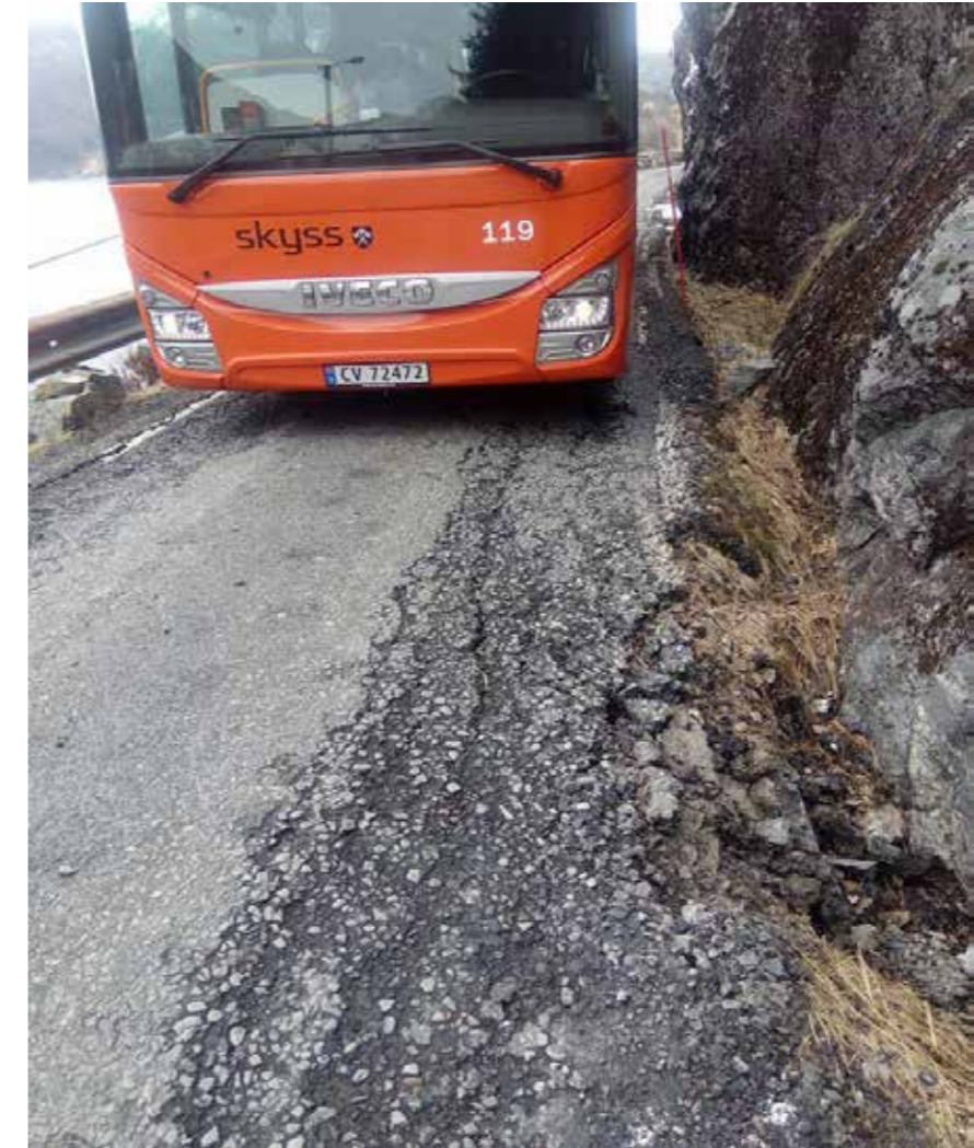
Når køyretøya er omlag like breie som vegen, så er det lett å forstå at det er vanskeleg å svinge utanom slike skader på vegen. I dag er dette «reparert» med ein klase asfalt. For vanlege folk er det lett å skjønna at skadane ligg djupare enn på overflata når så mykje av det opphavlege vegdekket forvitrar.
