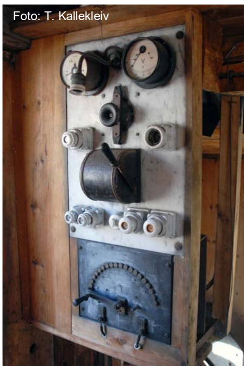
El-tavla i minikraftverket på Notland
