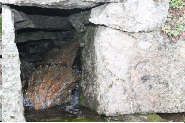
Th : Døme på kollaps.
