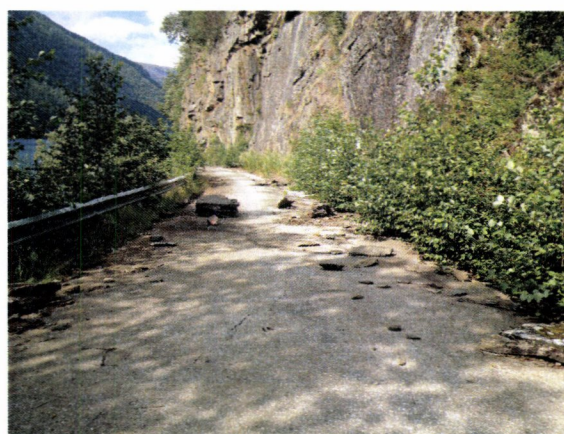
Små steinras/-skred ned på vegen
