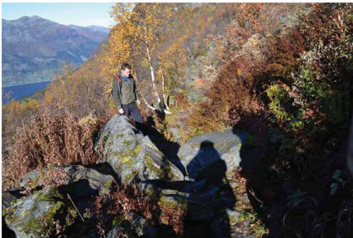
Bilete /GPS 5: Her er område kor det har kome ned mykje stein. Stein må fjernast og trasèen må bli breiare. Aktuelt med tiltak T4 . Foto: HFK
