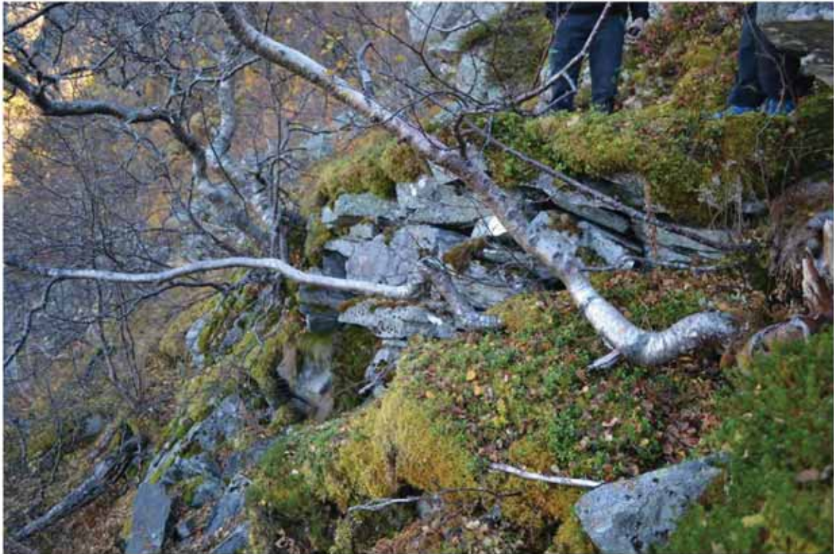
Bilete /GPS 2: Oppmura parti som må reparerast/ sikrast. Aktuelt med tiltak T2 Foto: HFK
