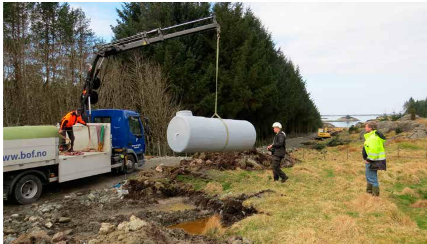
Tank til nytt toalett i Årvikane friluftsområde i Austrheim.
