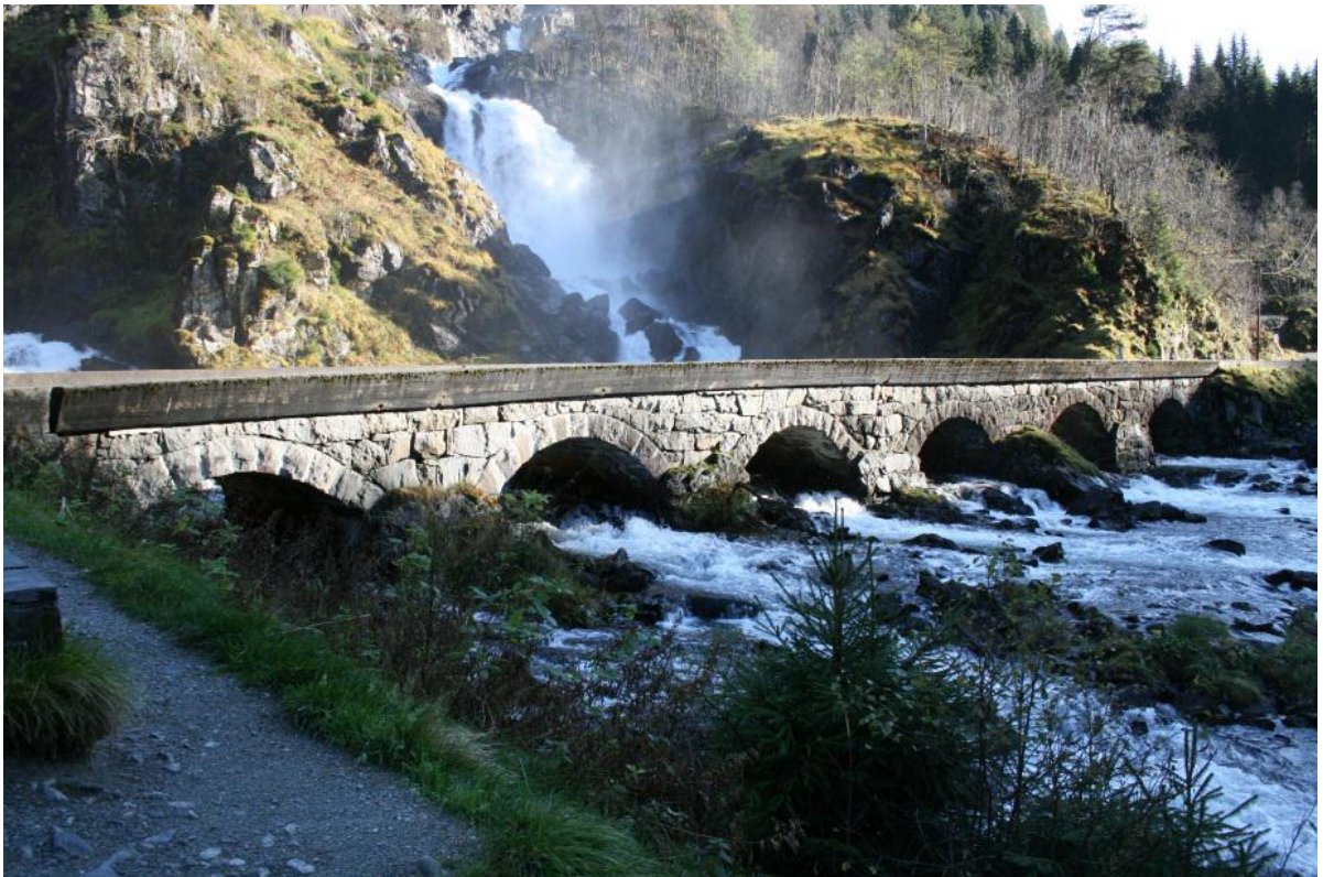
Figur 22: Steinbrua saman med fossen Låtefoss utgjer eit viktig veghistorisk anlegg – og er også ein populær turistattraksjon
