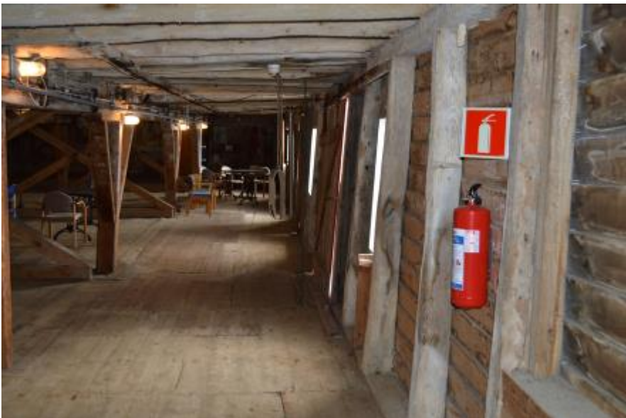
2. etasje, hovudrommet i sjølve boden sett mot aust. Til h. ytterveggen mot sør
