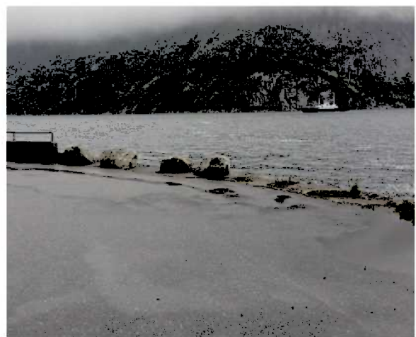
Figur 30 Manglende markering av kaikant mellom venterom og ferjekai
