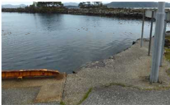
Figur 18 Kaikant der markering og sikring mangler.
