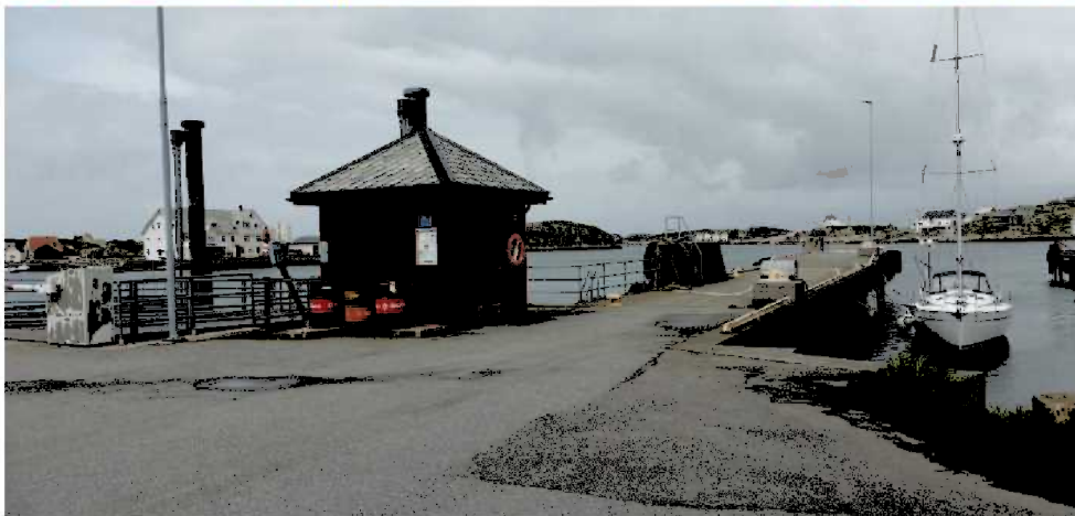
Figur 63: Sikring og god markering av kaikant mangler på en strekning.
