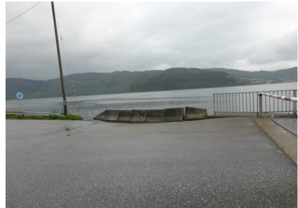
Figur 54 Delvis manglende rekkverk
