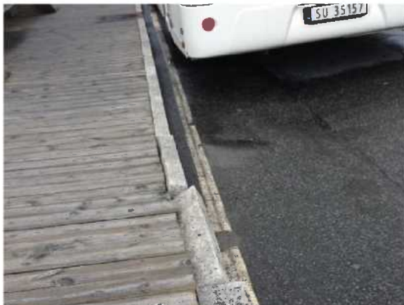
Figur 41 Tredekke og løs kantstein på bussholdeplassen.
