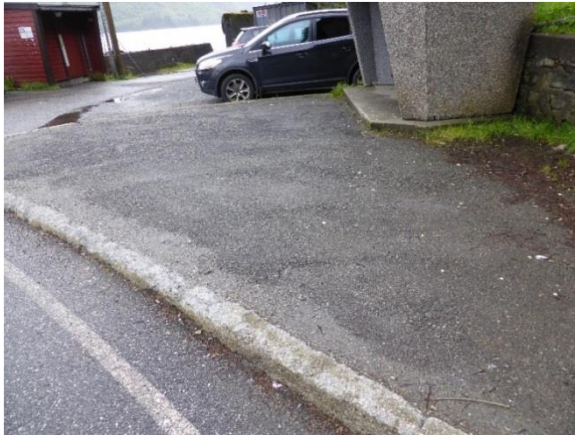
Figur 51 Dårligt og ujevnt dekke på plattform.
