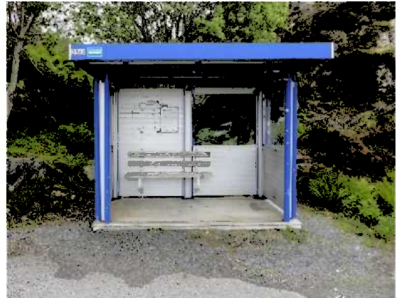
Figur 71 Særskilt dårlig dekke ved lehus. Ikke trinnfri atkomst.
