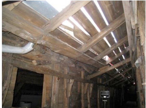
Dråpefallet før. Underside sløys under riving. Sett fra "broen" på foto 0724 mot bod 15. Diverse lag plater, beslag og bølgeblikk av nokså ny dato er fjernet. Her sees spikerslag mv fra 1920 eller nyere. Dårlig stand.
