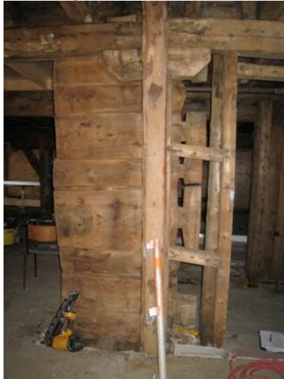
Laftevegg. Rester av. FØR. Nokså ustabil etter flere nyere åpninger.
