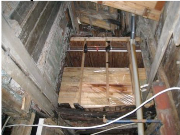
Dråpefallet før. Sett fra 1 etasje opp mot "bro" i 2 etasje, kledd med nyere plank og plast. Ikke brent. Råte og mugg. Bod 14 til venstre og bod 15 til høyre.
