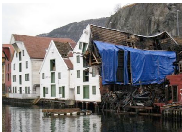
Sett fra sjøen. Etter brannen, før istandsetting. Bølgeblikk ødelagt i gavl bod 15.
