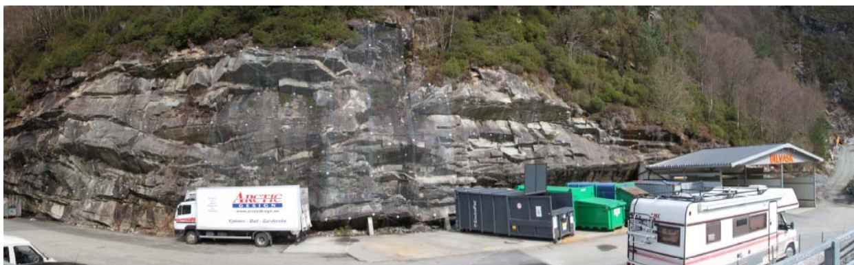
Fjellside hvor det nylig er gjennomført sikringstiltak med nett, bolter / lenker og bolter
