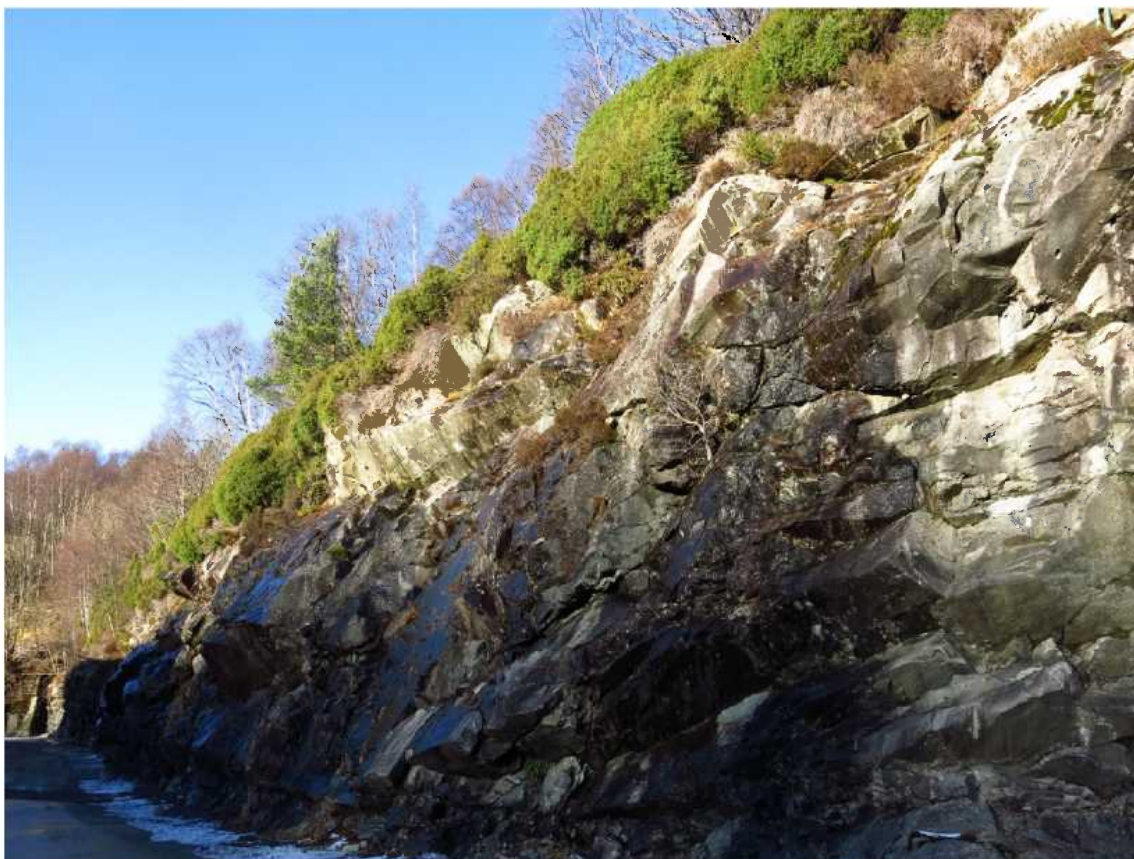
Bilde 4. Bergskrenter øst for planområdet. Mindre deler av berget er sikret med bolter, men gjenstår en del sikring for å oppnå god sikkerhet med hensyn på steinsprang.
