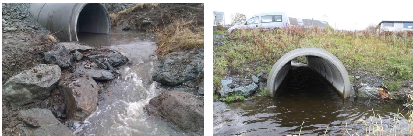
Figur 18: Ny turvei over Sakkestadbekken i Haugesund kommune. Kulvert med utløpskulp for fri passasje for fisk opp og inn i kulpen (t.v.). Kulvert med gjennomgående vannspeil og fri passasje for fisk gjennom kulverten. Utlagt stedegent bunnsubstrat (t.h.). Foto: Karl Otto Mikkelsen, COWI
