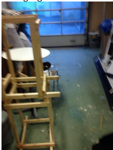
Uisolert gulv i dette «garasje-rom»
