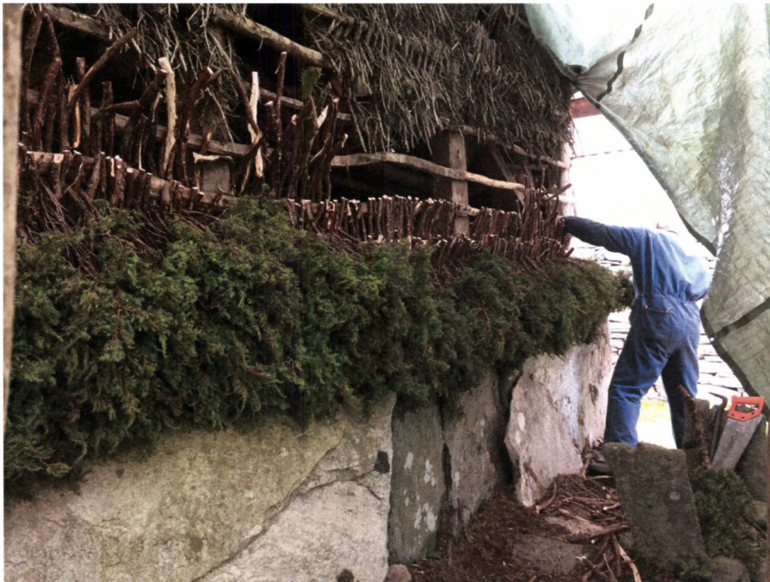
Ved å riva gammel kledning etter kvart som ein trer den nye, har ein referansen framfor seg.
