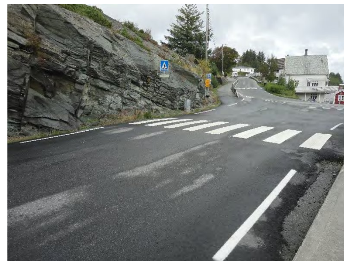
Bilde ovanfor viser feil tilrettelagt gangfelt/g/s-veg
