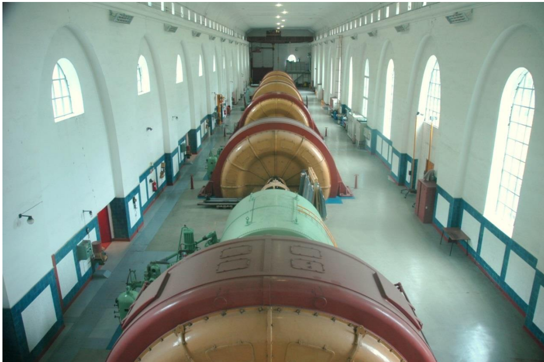
Dokumentasjon Glomfjord kraftverk 2008 – fotograf Harald Hognerud (NVIM)
