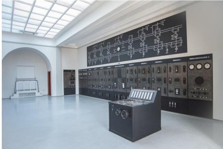
Nore kraftstasjon for NVE – til utstillinga «Kraftfull kultur – kulturminne i norsk kraftproduksjon» 2013. (Foto: Harald Hognerud, NVIM)
