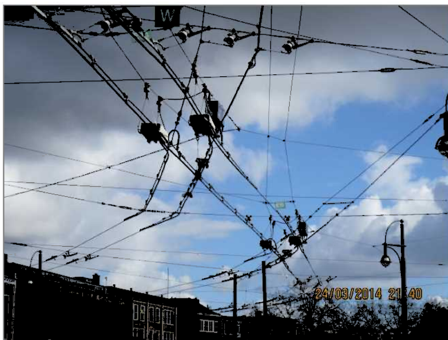
Figur 21. Kontaktledningsanlegg kan være dyrt å kjøpe.
