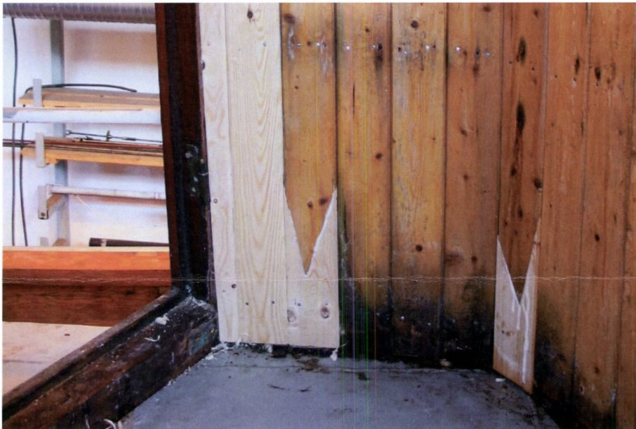
Et forsøk på å bevare mest mulig av de opprinnelige panelene i styrhuset på «RS Bishop Hvoslef». Råteskadde deler er byttet ut med frisk materiale av tilsvarende kvalitet. NNFA.
