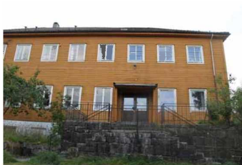
Steinmuren, smijensgjerdet og dobbeltrappen preger inngangspartiet til Willy Valentinsens vei 34. Bilde: Byantikvaren.
