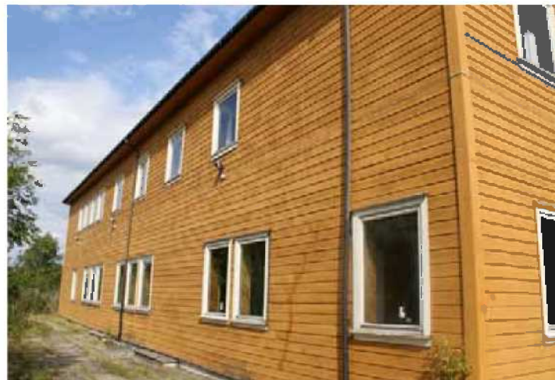
På fasaden i vest har endringer brutt den opprinnelige rytmen og symmetrien. De tre dørene er bygget igjen. Bilde: Byantikvaren.
