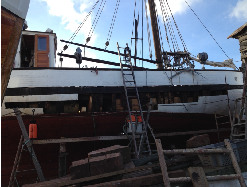
Oppe på slippen ble også det nederste bordet mot vannlinjen revet.
