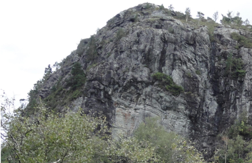
Bilde 12: Blikk mot nordøst på Ullberget. Berget viser løse blokker og åpne sprekker samt vann på overflaten.
