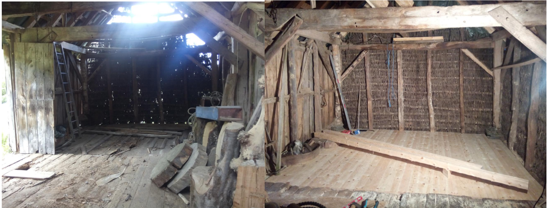
Figur 6: Gulv mot nord før og etter.
