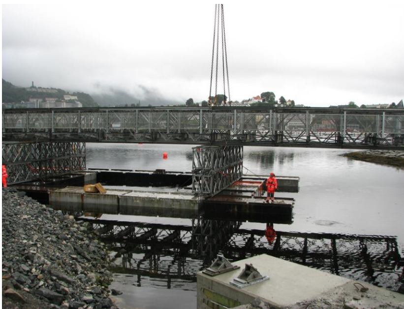
Midlertidig bro for utfylling av steinmasser løftes på plass. Foto: Ingrid Feet Bjørgo.
