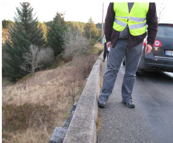
Låg / forskuva støypekant på Sturevegen
