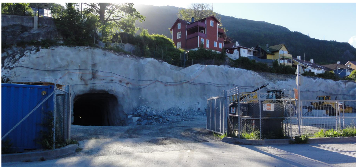
Påhugg for anleggstunnel mot Ulrikstunnelen. Påhugg for alternativ 2 er tenkt rett til høyre for anleggstunnelen(Sweco)
