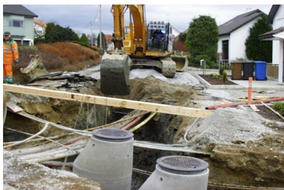
Sanering av vann- og avløpsledninger, Vibeveien i Sandnes kommune. Foto: Aksjon Jærvassdrag
