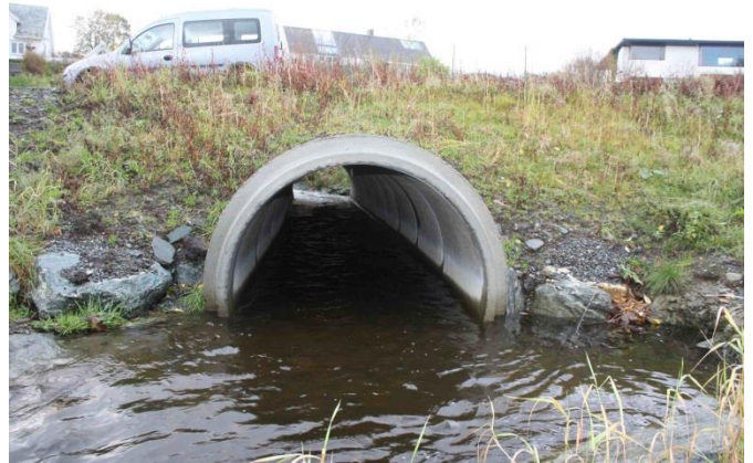
Kulvert med gjennomgående vannspeil og fri passasje for fisk gjennom kulverten. Utlagt stedegent bunnsubstrat.
